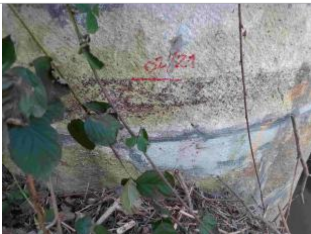
Marque sous le pont, amont RG
