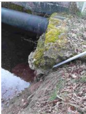
Trace de débris sur le pont
