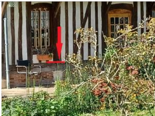
Laisse de crue en haut de la poutre au dessus du mur de brique sur la façade EST, à 65 cm/sol.
