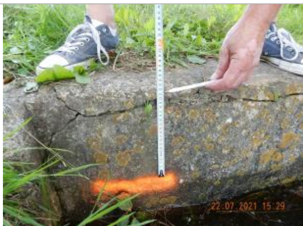
Marque de peinture sur rebord en ciment du pont. (rive Gauche du "Tordoir")
