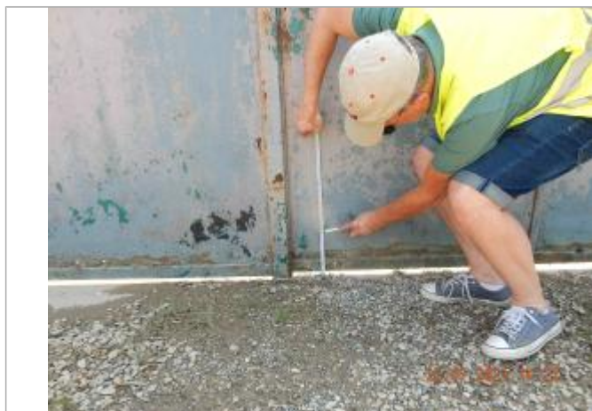
Laisse de débris végétaux sur portail métallique à 19 cm/sol
