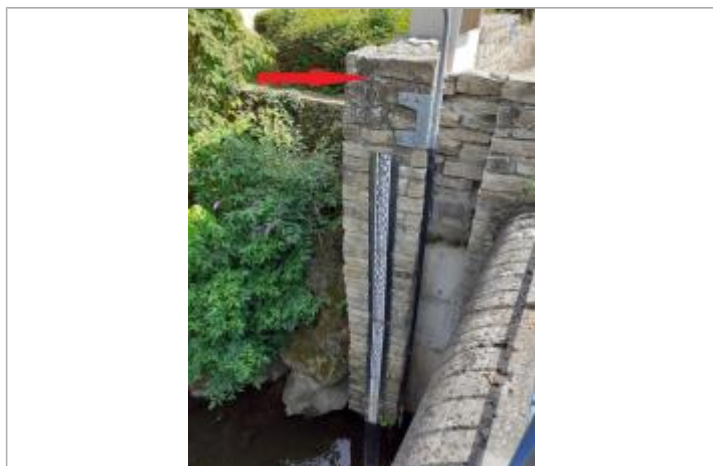
Echelle limnimétrique en amont du pont
