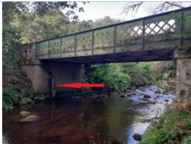
Pont de la RD 132 entre Priziac et Le Fauët vue de l'aval
