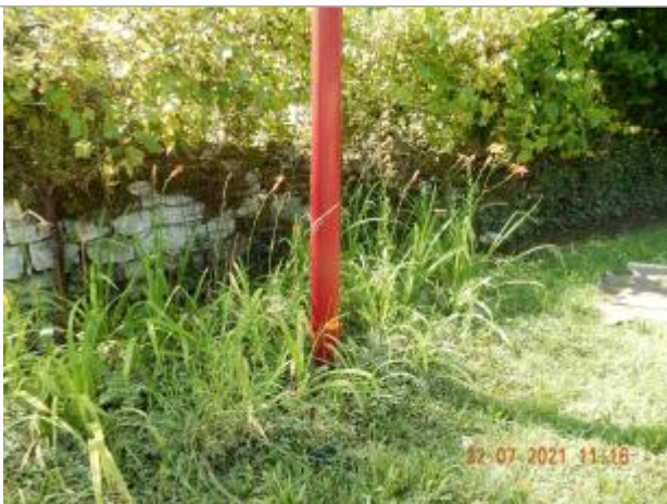
Laisse de crue sur poteau du lampadaire à 26 cm/sol
