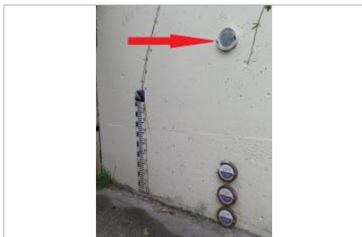
vue des repères du passage piéton
