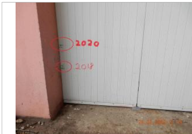
Marque de feutre sur porte de garage
