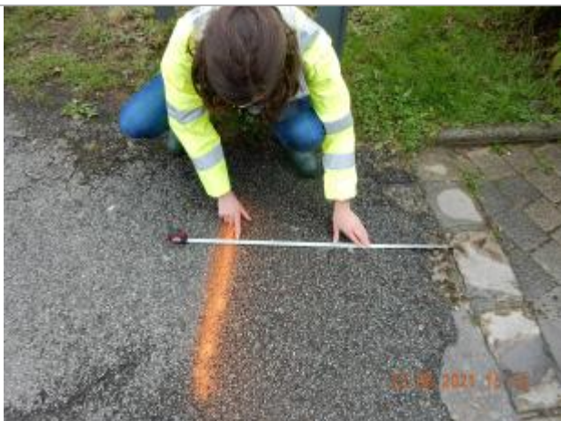
Marque de peinture sur la chaussée de la ruelle
