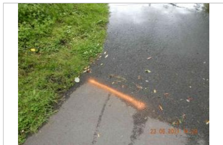
laisse de crue au sol sur voie piétonne
