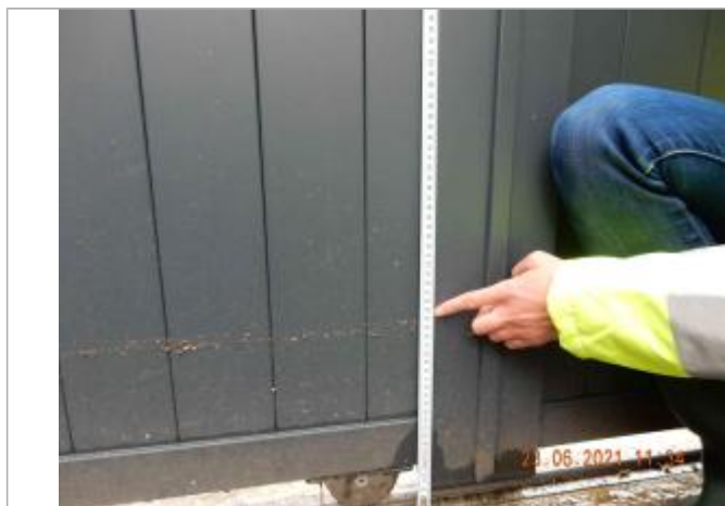
laisse de crue sur portail à 24 cm/sol
