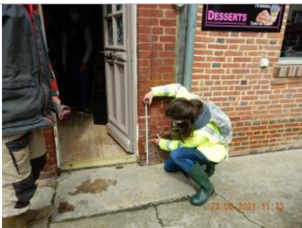
Laisse de crue sur mur à 29 cm/sol
