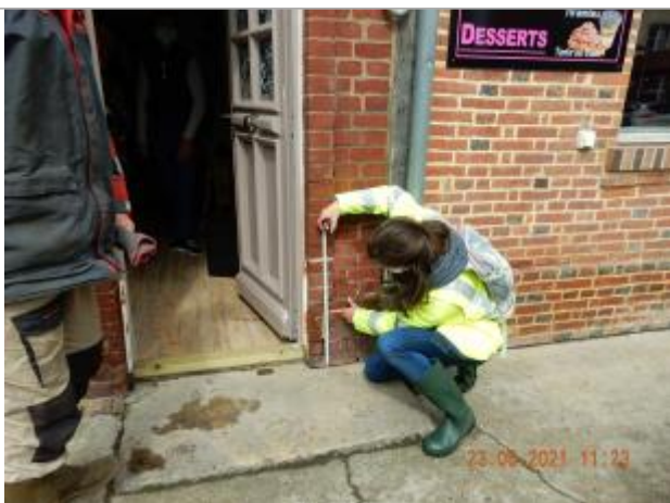
Laisse de crue sur mur à 29 cm/sol
