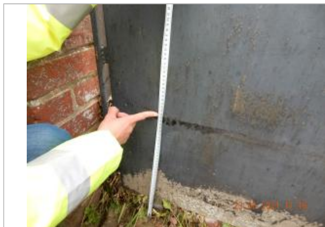
Laisse de crue sur portail à 37 cm/sol
