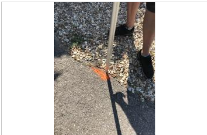
Laisse de crue au sol
