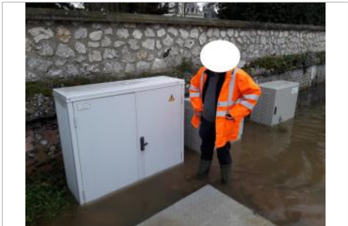
Laisse de crue à cm en dessous du gond de la porte de l'armoire électrique.
