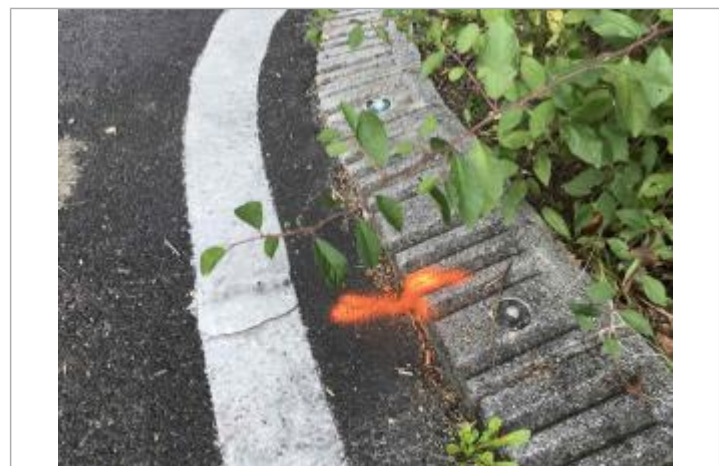
laisse de crue au sol sur bordure trottoir
