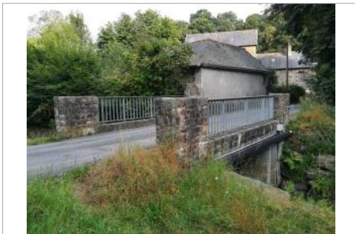
Station hydrométrique de l'IC à Binic
