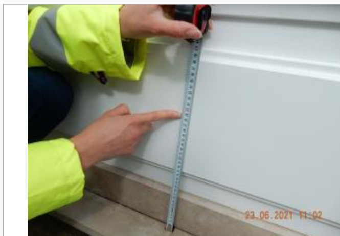
Laisse de crue sur mur à 29 cm/sol
