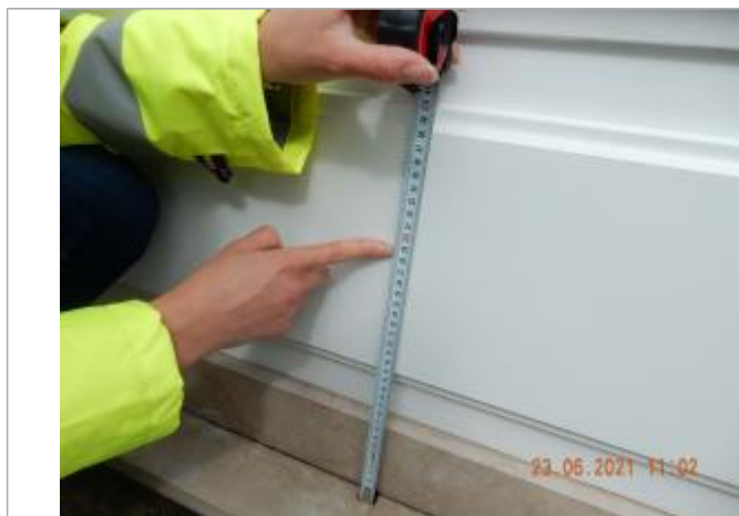
Laisse de crue sur mur à 29 cm/sol
