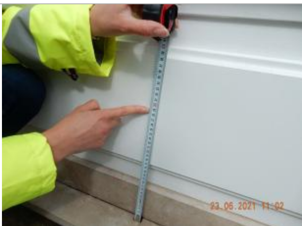
Laisse de crue sur mur à 29 cm/sol
