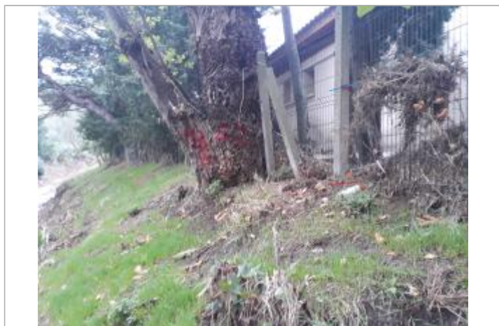
Vue du repère - Photo © CCGST
