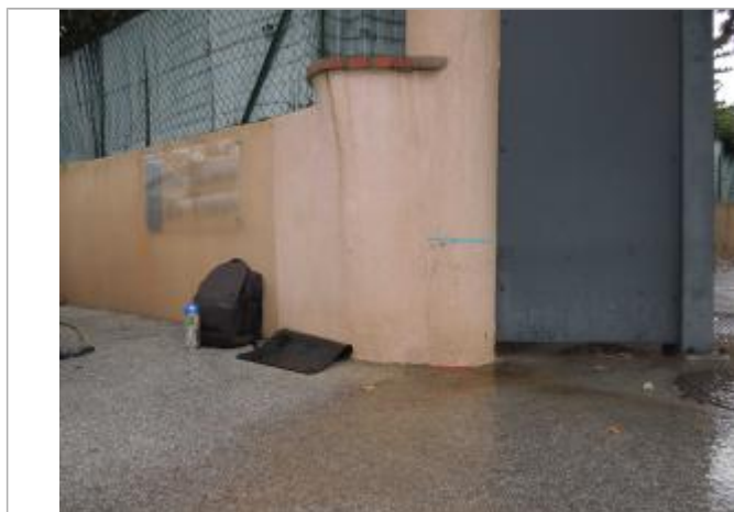
Vue du repère - Photo © CCGST
