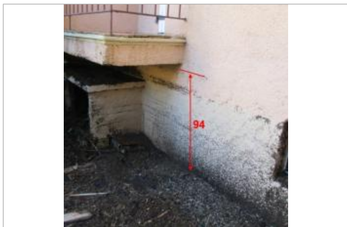
Vue du repère - photo DDTM83
