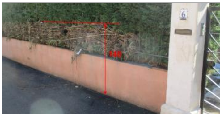
Vue du repère - photo DDTM83
