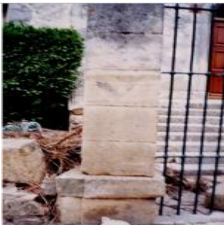
Vue du repère - photo DDTM83
