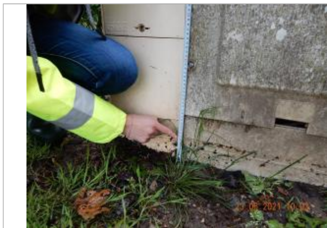
laisse de crue sur compteur électrique à 9 cm/sol
