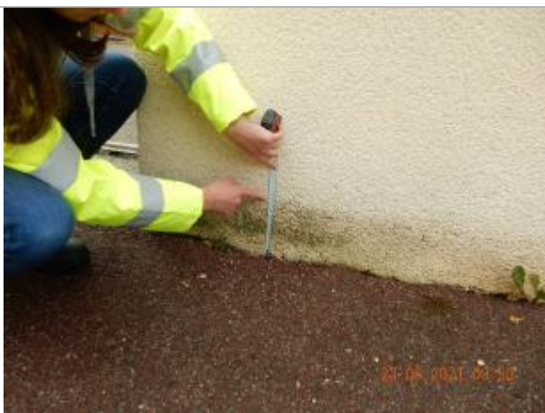
Laisse de crue sur mur à 15 cm/trottoir
