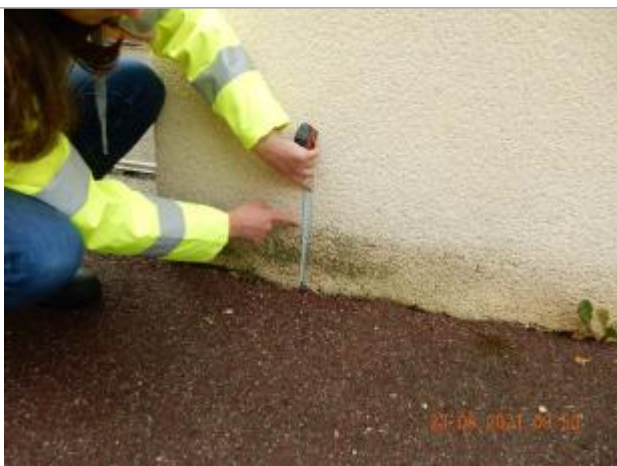
Laisse de crue sur mur à 15 cm/trottoir
