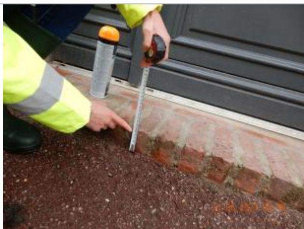
Laisse de crue au niveau du haut de la marche
