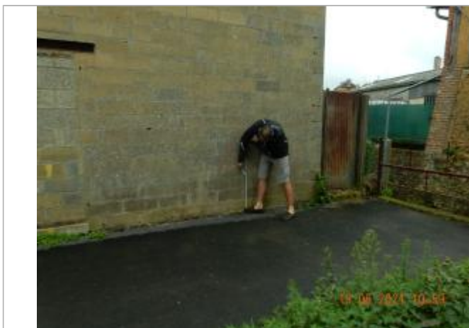
laisse de crue sur le mur à 53 cm/sol
