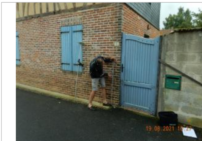
laisse de crue sur mur en brique
