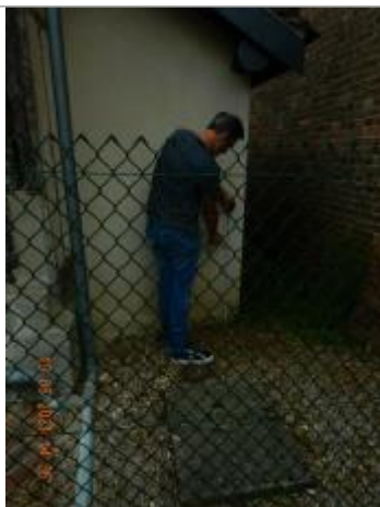
Marque de peinture sur mur
