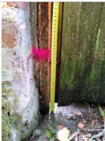
laisse de crue à 25 cm/margelle
