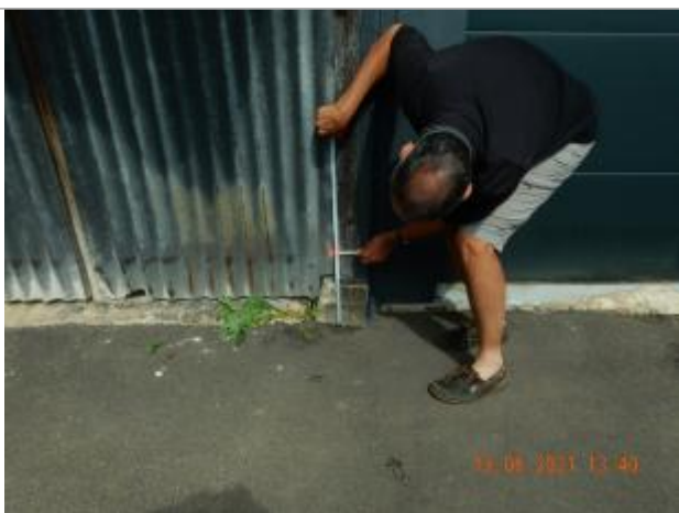
Marque de peinture sur porte de garage
