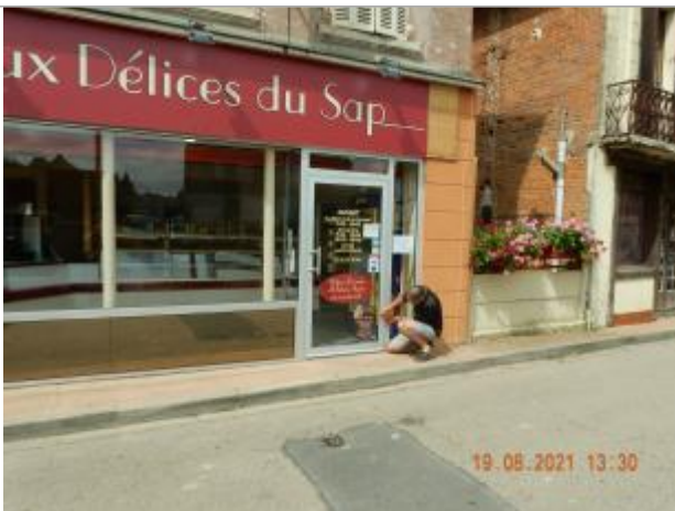
laisse de crue à 10 cm/sol de la boulangerie
