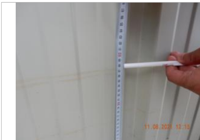
laisse de crue sur porte de garage à 88 cm/sol
