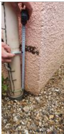
laisse de crue sur mur à 30 cm/sol
