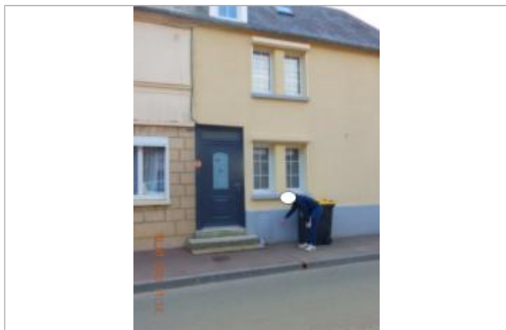
laisse de crue sur façade de la maison à 34 cm/sol.
