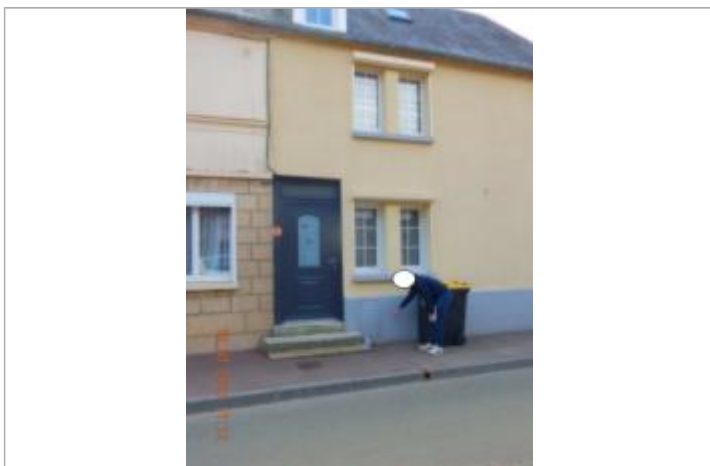
laisse de crue sur façade de la maison à 34 cm/sol.
