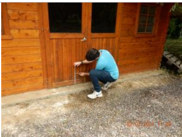
laisse de crue à 24 cm du sol sur mur en bois
