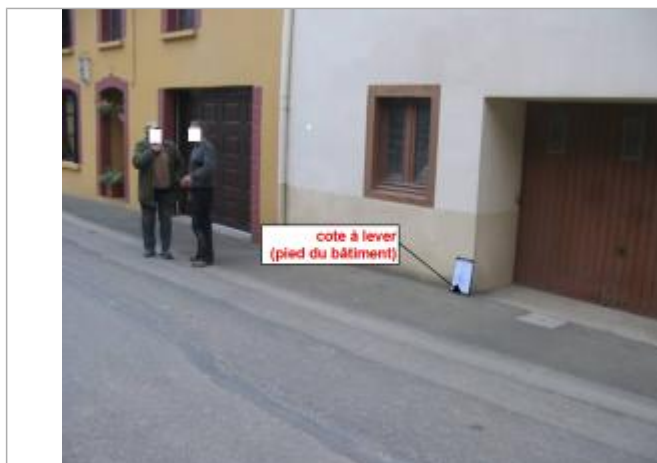
Pied du mur coté gauche de la porte de garage au n°13
