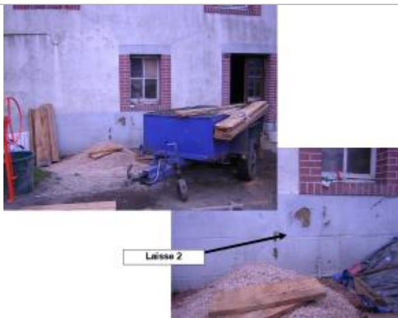
Sur le mur, sous la fenêtre, 2eme rainure
