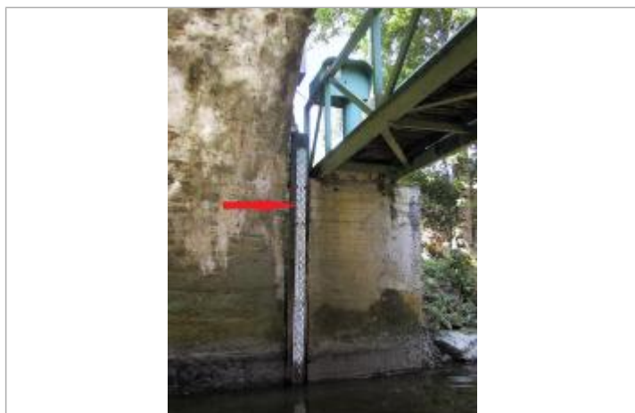
Echelle limnimétrique de la station du Lié à La Prénessaye
