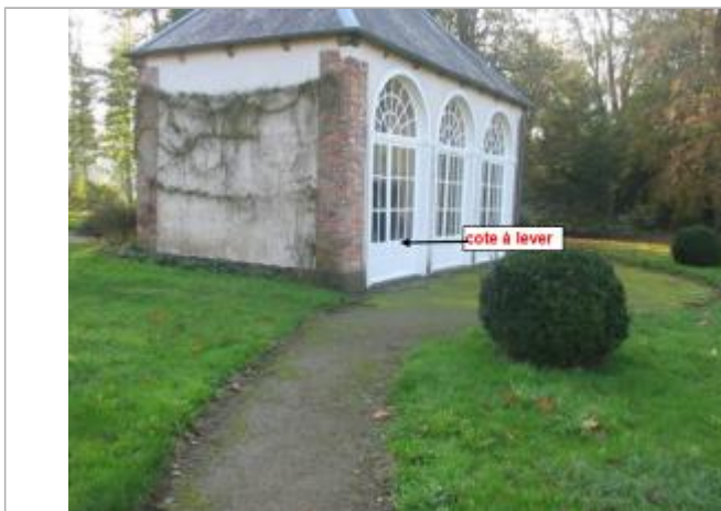
extrémité bas du vitrage de gauche sur le bâtiment dans les jardins du château de VauBlanc
