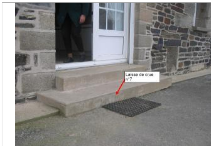
Dessus de la 1ère marche de la porte d'entrée de l'habitation
