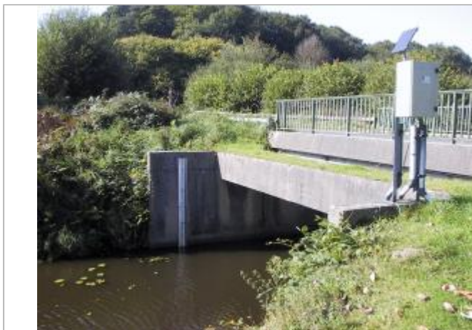
Station hydrométrique du Blavet à Lanrivain
