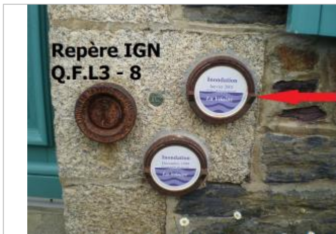
Repère normalisé de l'inondation du 6 janvier 2001
