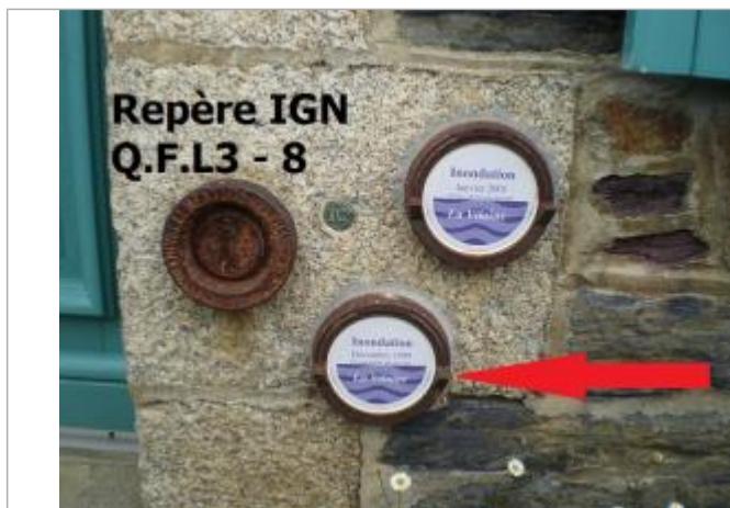
Repère normalisé de l'inondation du 29 décembre 1999
