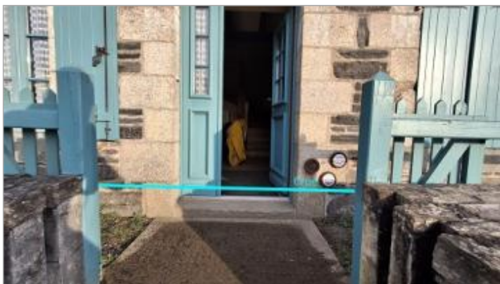
Laisse de la crue de 2025 sur la façade de la maison éclésièrre - photo Conseil Régional de Bretagne - voies navigables
