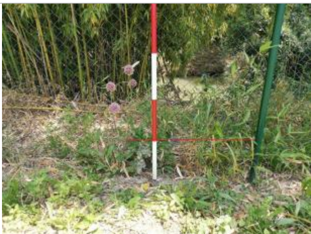
Trace de boue sur grillage - Photo © AGERIN
